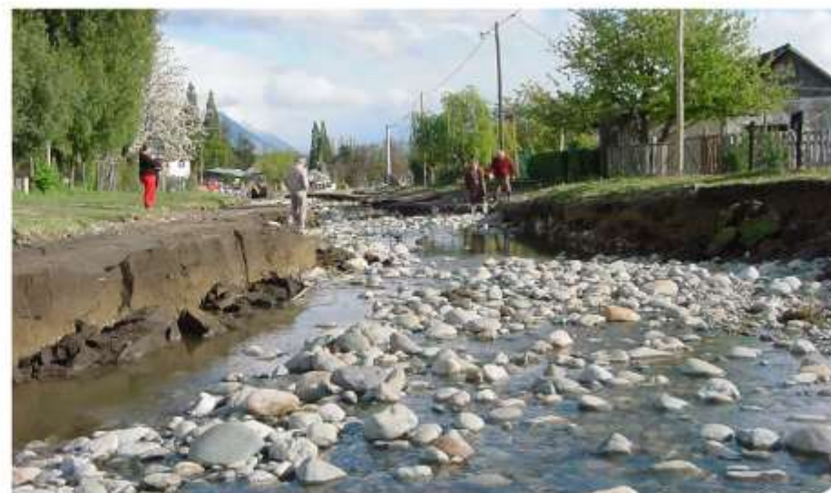
Colapso de calles y servicios
