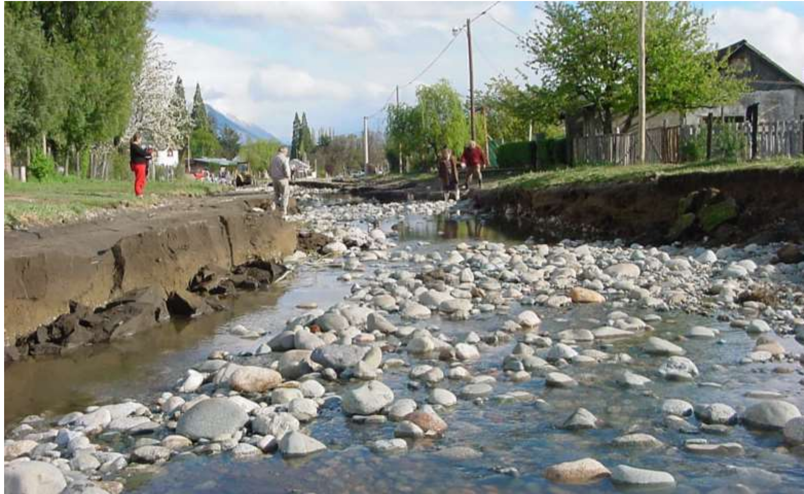
Colapso de calle y servicios
